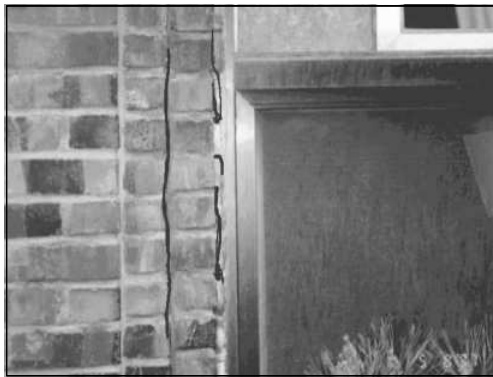
<사진 3.4> 개구부 주위의 균열 I
