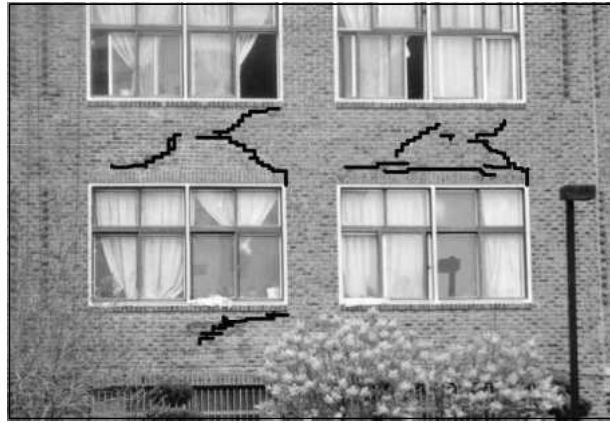
<사진 3.1> 부동침하에 의한 균열
