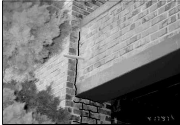
<사진 3.6> 캔틸레버주위의 균열
