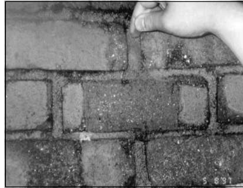
<사진 3.9> 시공상의 결함에 의한 모르터의 파손
