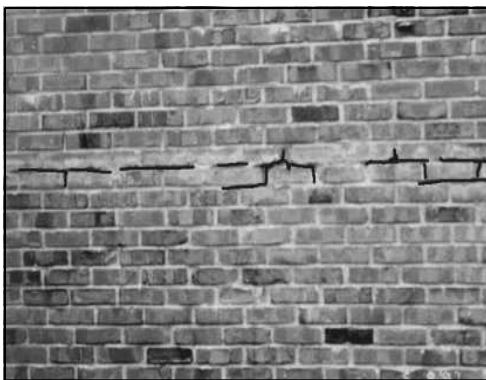
<사진 3.2> 집중하중에 의한 균열
