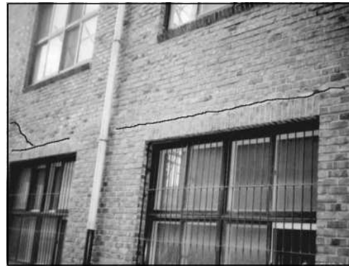
<사진 3.5> 개구부 주위의 균열 II
