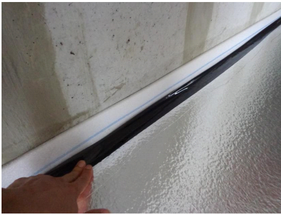
측면완충재와 완충재 테이핑불량
