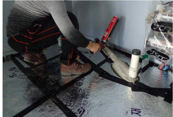
배관주변 완충재 밀실시공 불가
