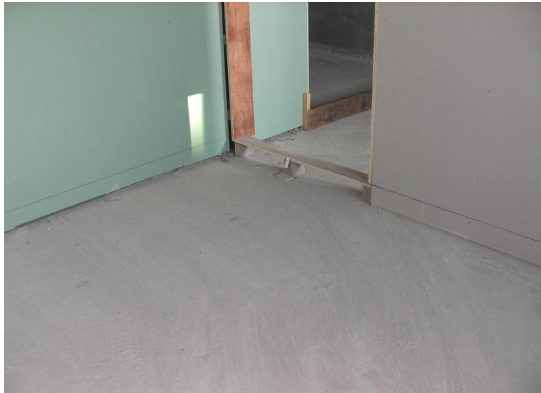
시공불량 목재 분합문틀 하부
