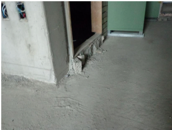
분합문 하부 사춤부위 돌출
