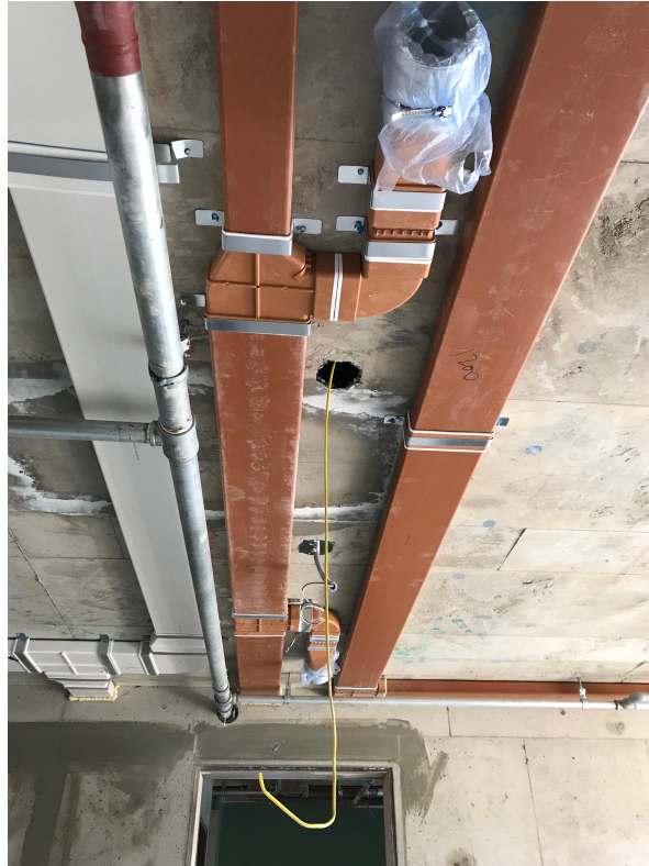
<그림 8-3> 공동주택 세대내 환기장치 설치모습
