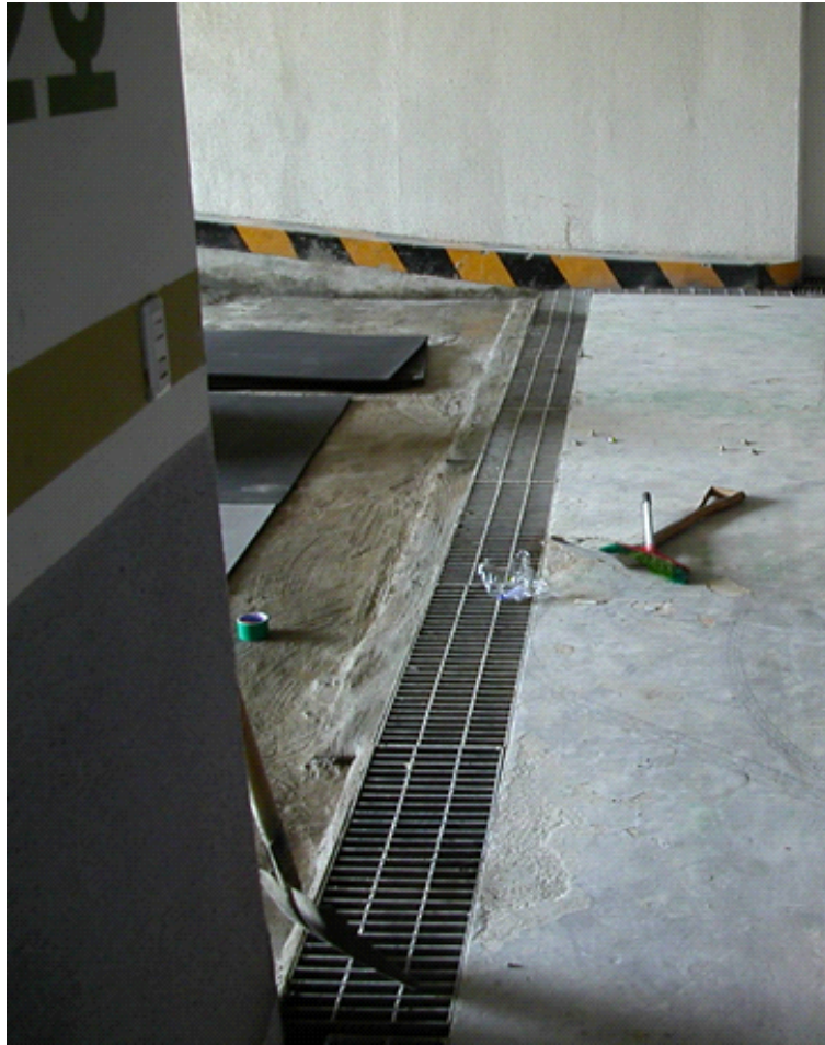
<그림 2-16> 소음 민원이 발생한 지하주차장 진출입구 배수구 모습의 예
