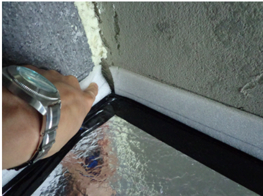
코너부위 측면완충재 이음부 유격
