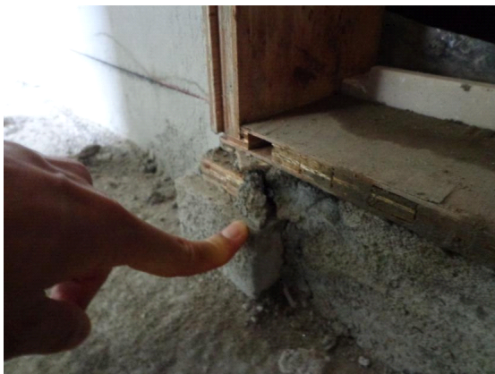
분합문 하부 사춤부위 도출
